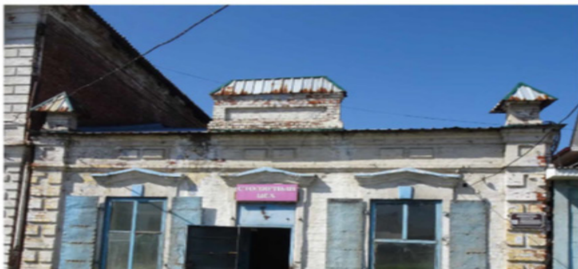
Фото 4. Следы намокания в карнизной части. . Коррозия кровельного покрытия аттиковой стенки и парапетных столбиков.
