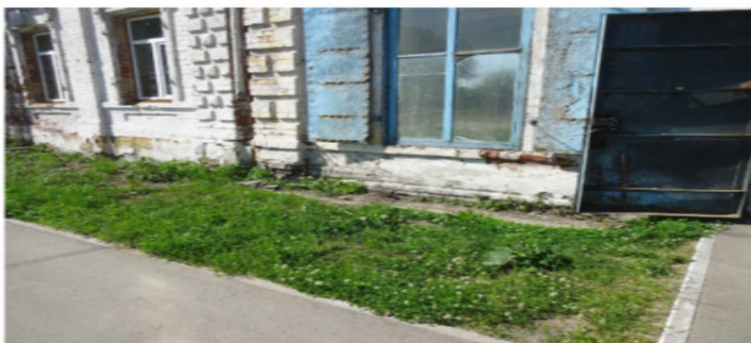
Фото 2. Отсутствие отмостки. Деструкция кирпичной кладки.
