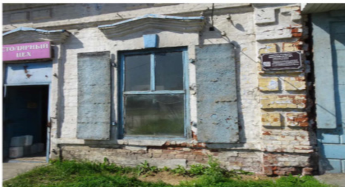
Фото 3. Отсутствие отмостки. Деструкция кирпичной кладки, осыпание окрасочного слоя.
